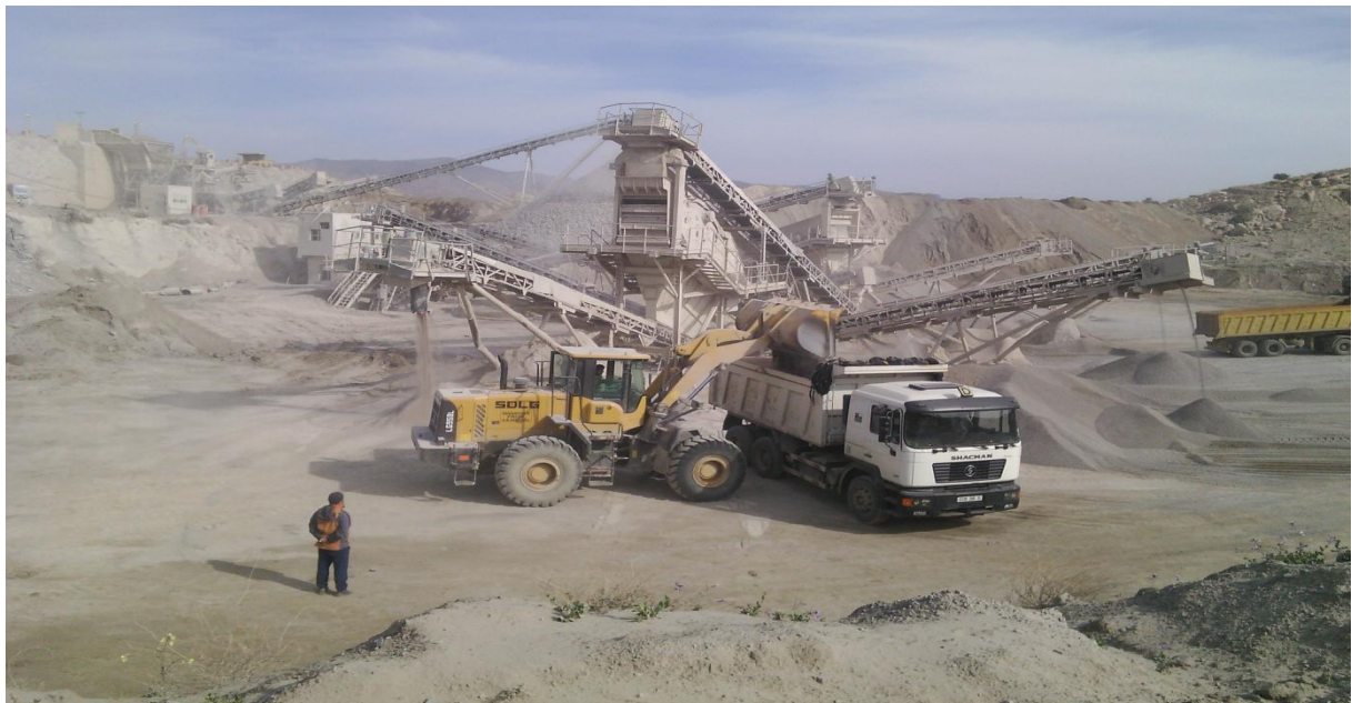
Figure III.1 : Station de concassage de la carrière AGREM (photo ; 2016).
