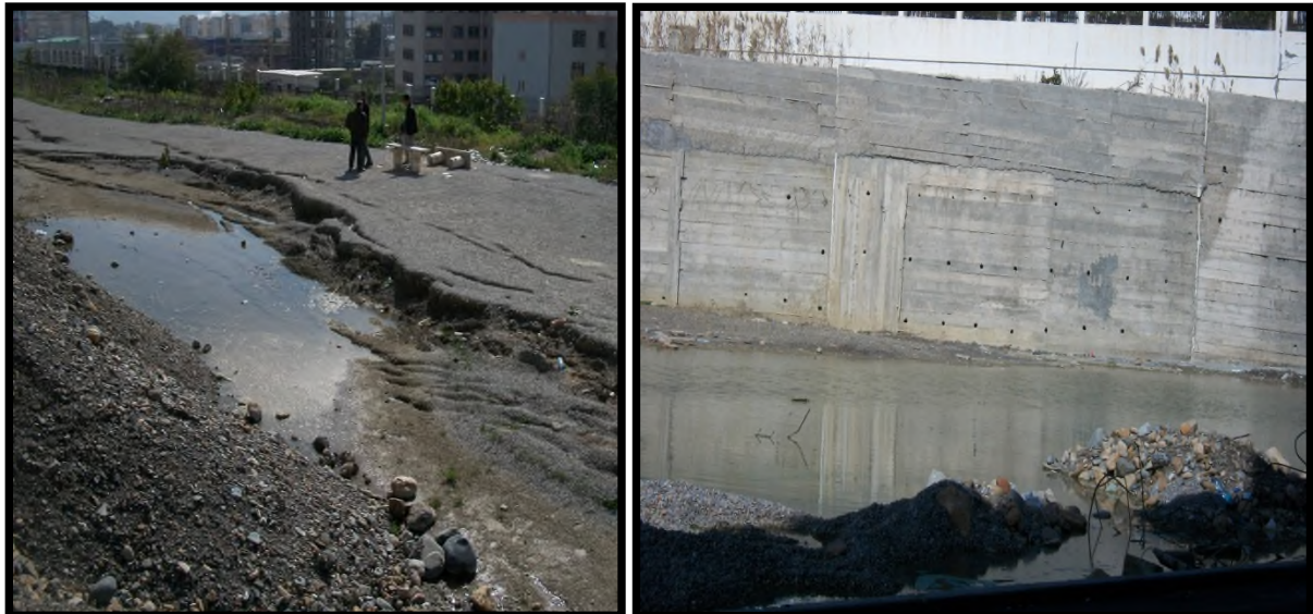
Figures I.7 : Affaissement du terrain et stagnation des eaux.
