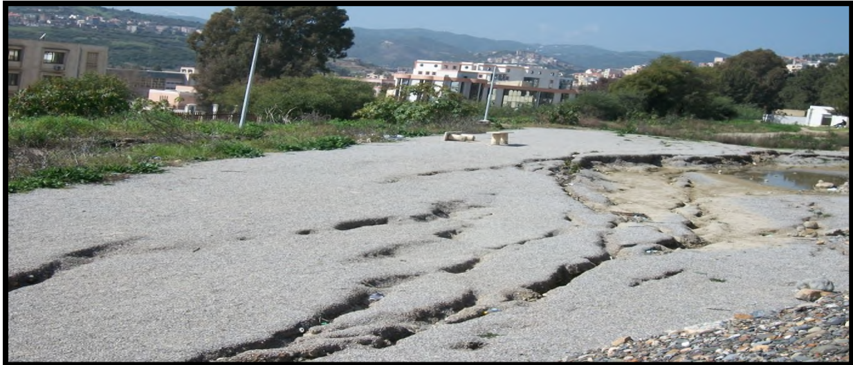
Figure I.6 : Fissures, tassements sur la plate forme du stade.
