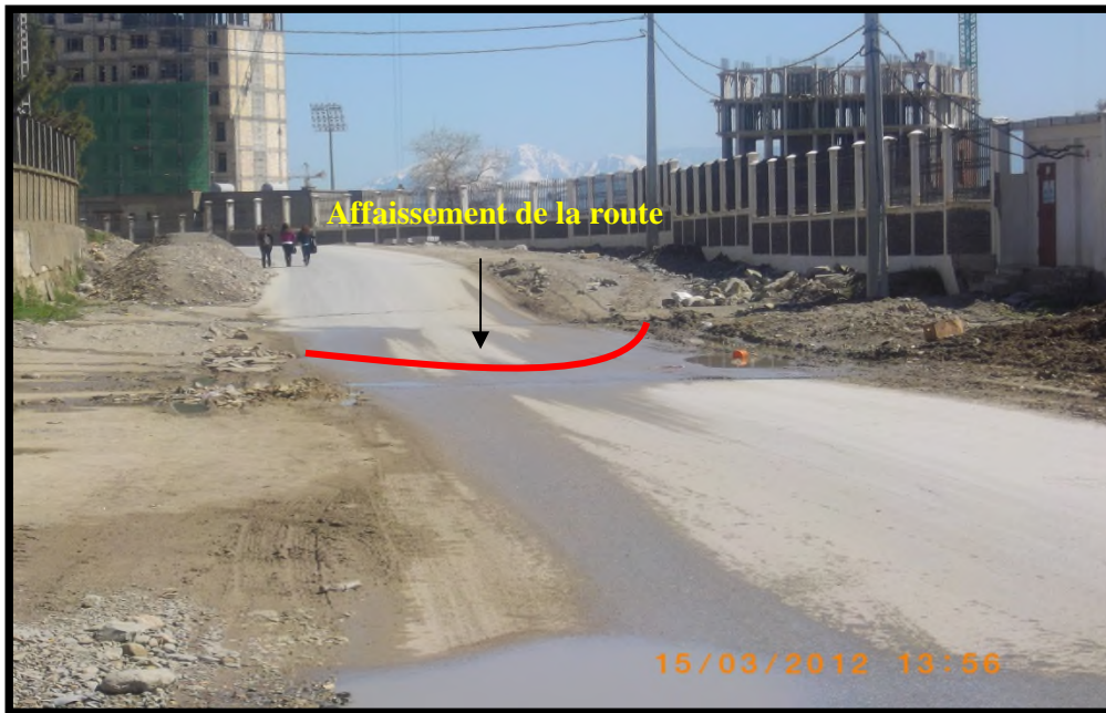
Figure I.10 : Affaissement et bombement de la chaussée.
