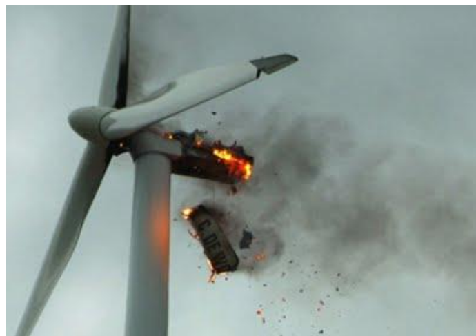
Fig. III.1 – Destruction d'une éolienne par prise de feu.
