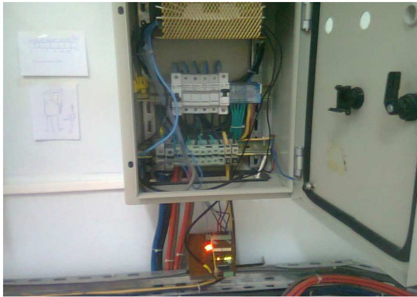
FigIV-14 : Armoire pour le branchement des cables 60
