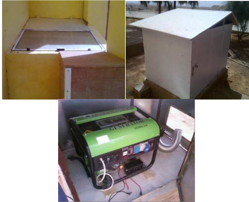
FigIV-16 :Le generateur diesel et l'emplacement des batteries
