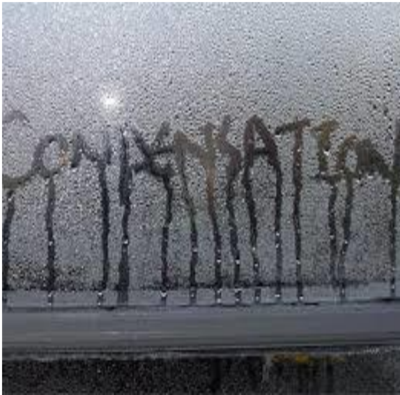
a) Condensation d'eau sur une fenêtre en hiver
