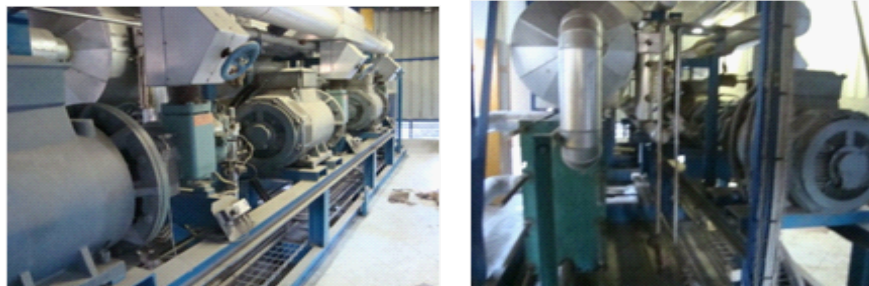
Figure 2 – 24 : Refroidisseur des souffleuses (CLAUGER)
