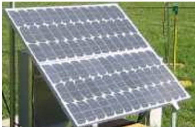
Figure (I.8) : Champ de panneaux solaires [18].
