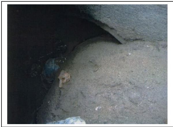
Fig. I-5 : Ensablement du réseau dans la zone de MKasseb (Jijel).
