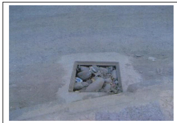
Fig. I-10 : Obstruction d'un avaloir dans la zone de construction suite à l'absence de grille (Jijel).
