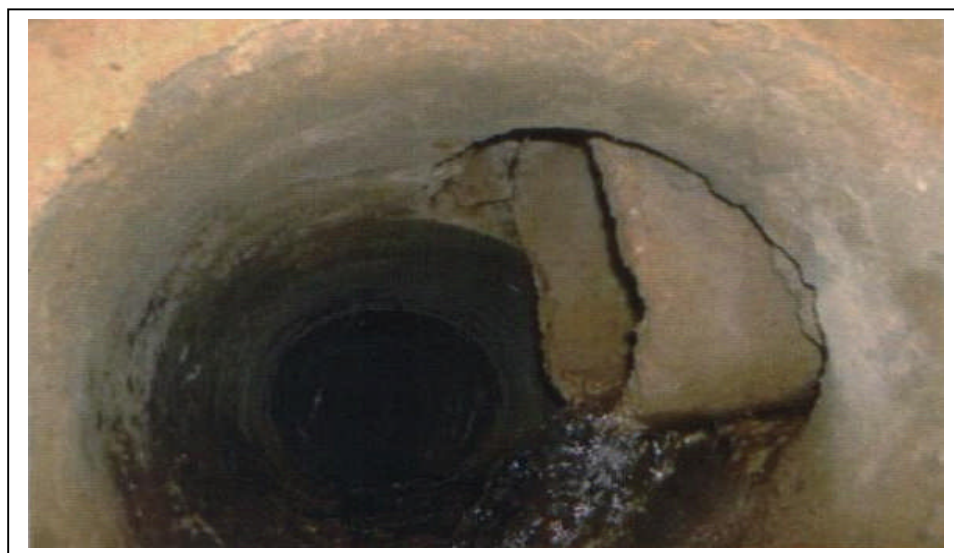
Fig. 7 : Captation des fuites d'eau potable.
