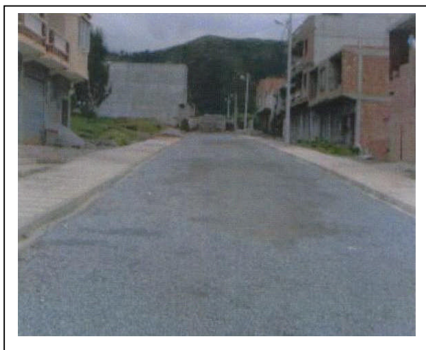
Fig. 3 : Chaussée nouvelle obstruant les regards et les avaloirs
