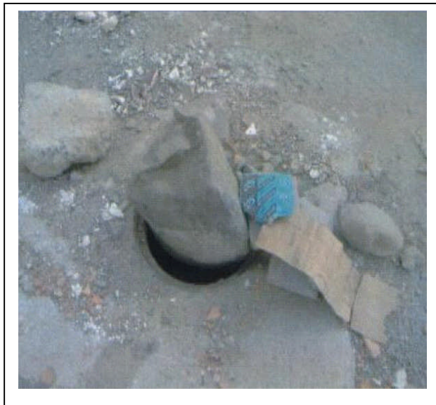
Fig. 1 : Obturation sommaire de l'entrée du regard par une pierre après le vol du tampon.
