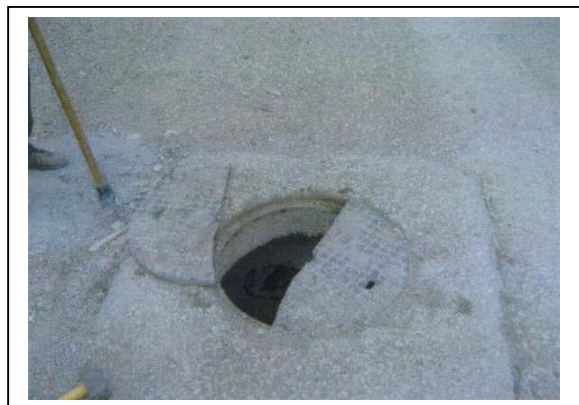
Fig. I-9 : Tampon cassé dans la zone du camp chevalier (réseau de Jijel).
