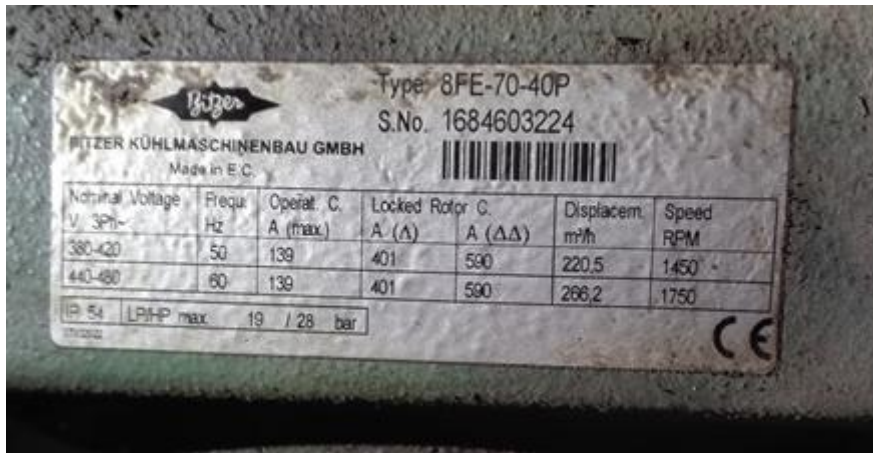
Fig. A : Plaque signalétique du compresseur.
