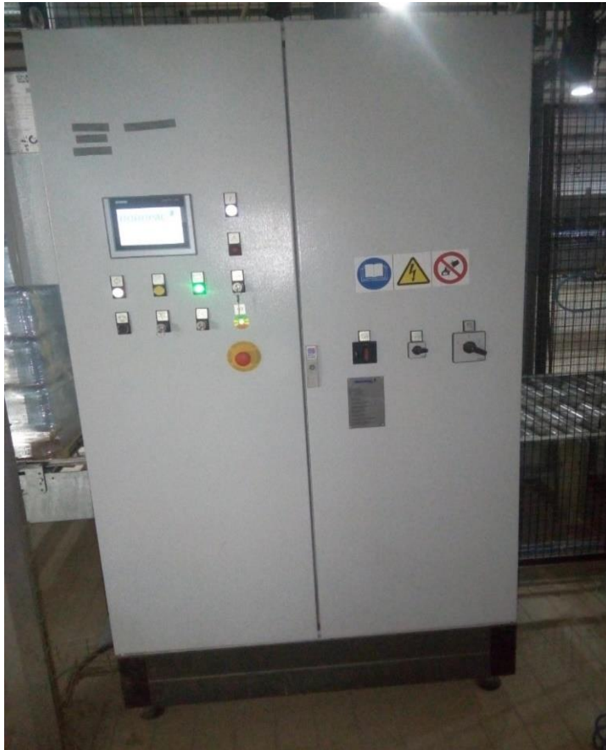
Figure (IV.3) : Vue extérieur de l'armoire électrique
