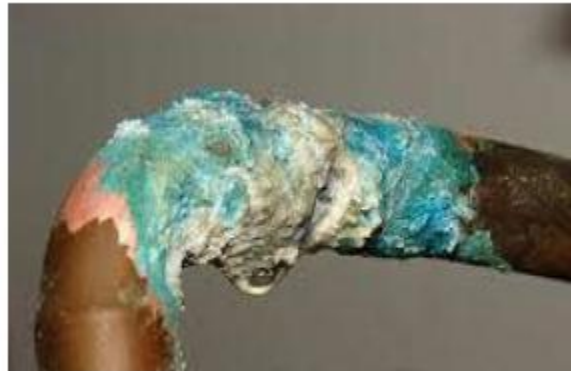
Figure I.3: Produits de corrosion du cuivre.
