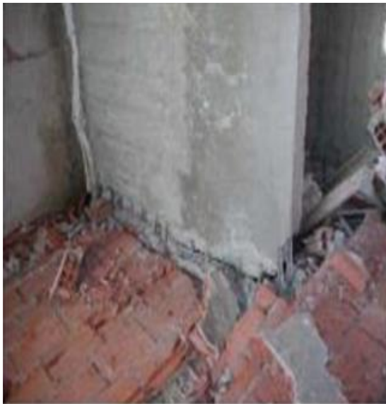
Figure II. 9 : Rupture de la section à la base du voile([32])
