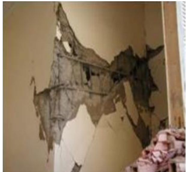
Figure II. 10 : Fissure ouverte dans le voile([32])
