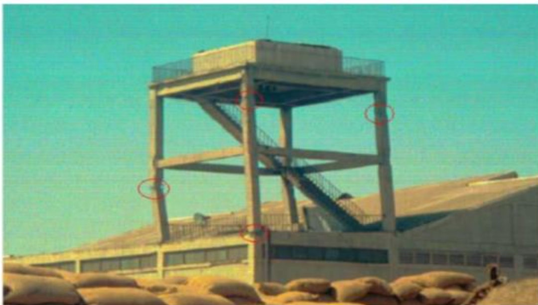
Figure II. 6 : Endommagement d'un portique à 2 étages par flexion dans les zones critiques des poteaux dans une installation portuaire lors du séisme de Buhj (Inde) en 2001
