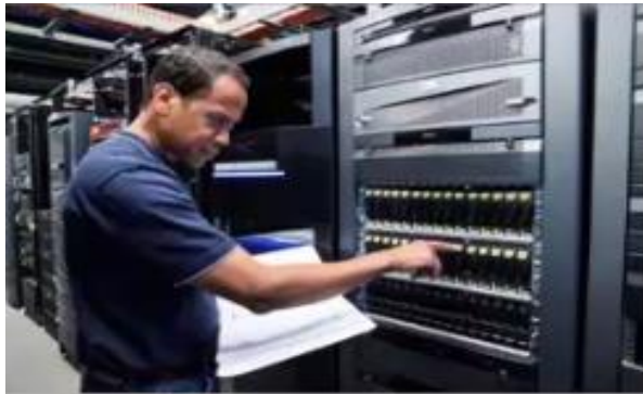
Figure 10 : DataCenter de la renaissance.
