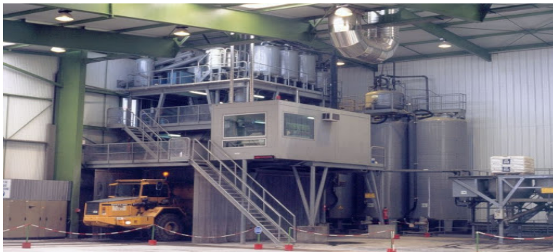
Figure I.4. Unités de stabilisation et solidification des déchets
