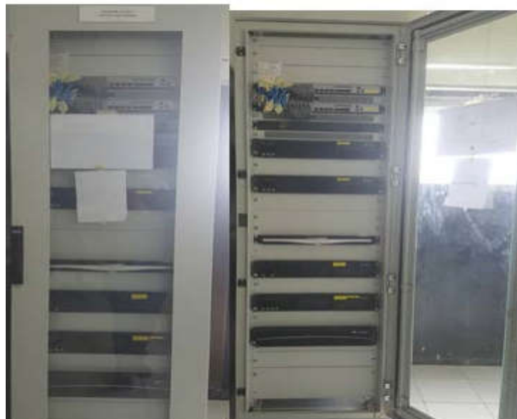
Figure2.10 : Armoire SCADA Terminal Arrivé Bejaia.
