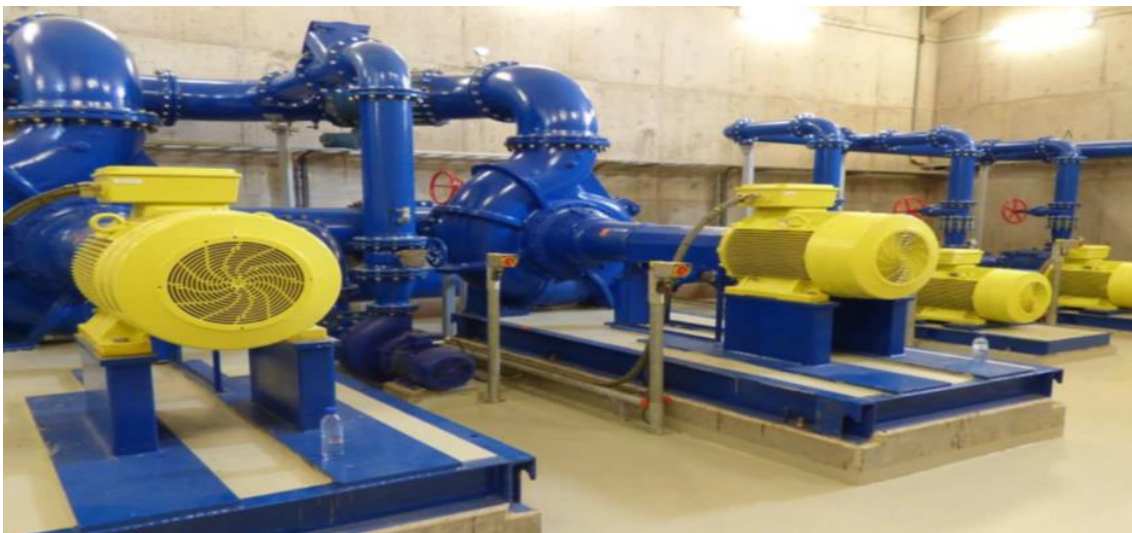
Figure II.2 : Station de pompage alimentée par le réseau électrique.
