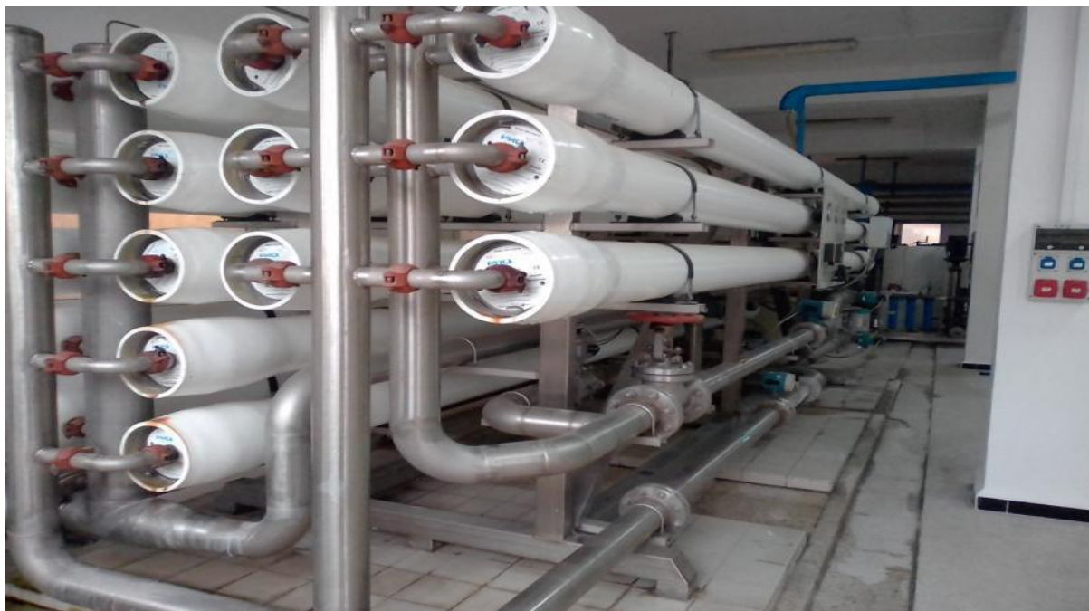
Figure II.6 : Une des lignes d'osmose inverse au niveau de CEVITAL.
