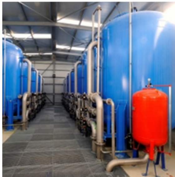
Figure II.4 : Photographie d'un filtre à sable au niveau de Cevital
