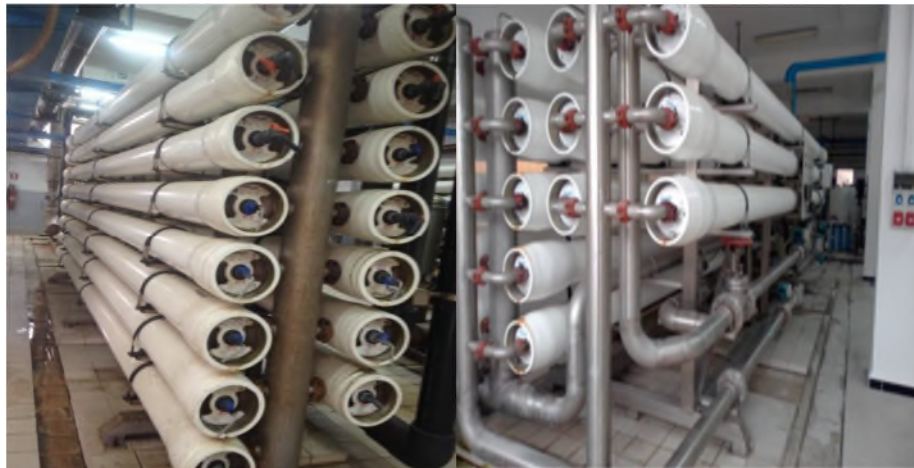
Figure II.8 : Photographie des lignes d'osmose inverse à CEVITAL.
