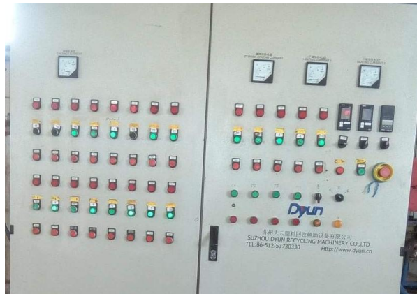
Figure III.32 : Tableau de bord électrique.
