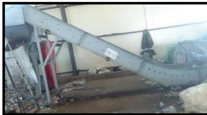
Figure III.12 : Le tapis élévateur de déchets.
