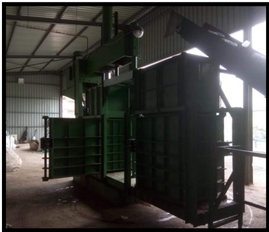
Figure III.9 : La presse de mise en balle.
