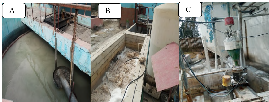
Figure 2.23 : (A) bassin de décantation, (B) ajout d'un flocculant, (C) neutralisation a la soude.
