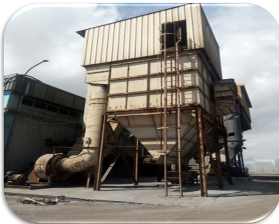
Figure 2.21 : Filtre à manche pour le traitement des fumées.
