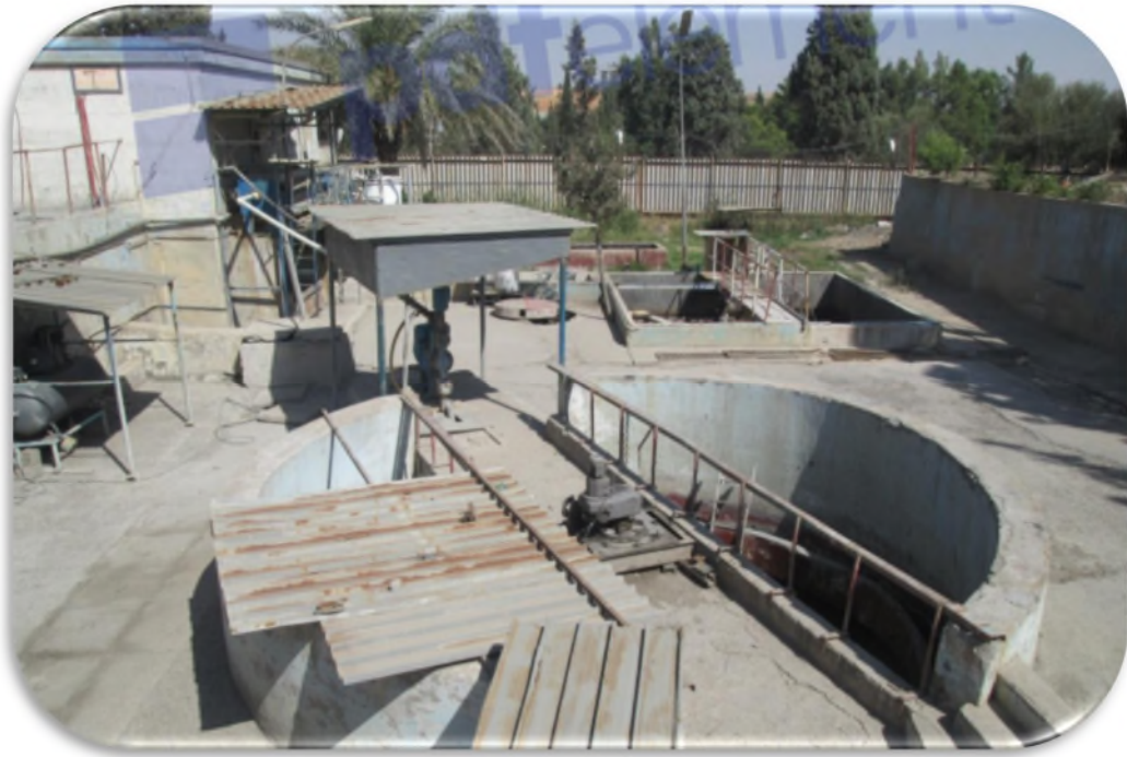
Figure 2.22 : station de neutralisation de l'ENPEC.
