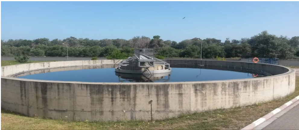
Figure 11 : Décanteur secondaire (cliché Akkal et Mertousse, 2019).
