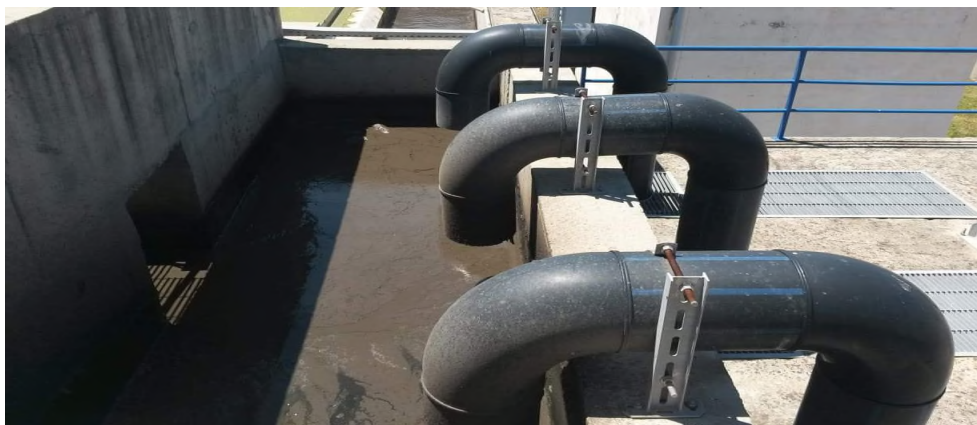
Figure 12 : Bassin de recirculation des boues (cliché Akkal et Mertousse, 2019).
