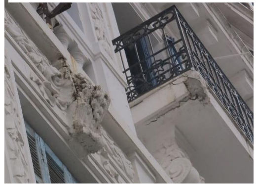
Figure II-87: apparition de fissurations au niveau de l'immeuble de Borge, Bejaia. Source : auteurs 2019
