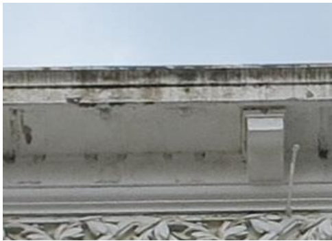
Figure II-86 : prolifération des moisissures au niveau de dernier étage de l'immeuble de Borge, Bejaia. Source : auteurs 2019
