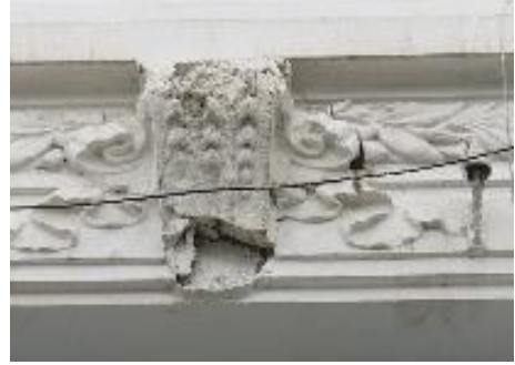
Figure II-85 : arrachement partiel d'ornement au niveau de l'immeuble de Borge, Bejaia. Source : auteurs 2019
