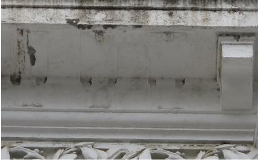
Figure II-84 : arrachement total d'ornement au niveau de l'immeuble de Borge, Bejaia. Source : auteurs 2019
