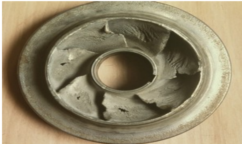
Figure IV.6: Effet de la cavitation (et/ou érosion) sur la roue d'une pompe centrifuge.
