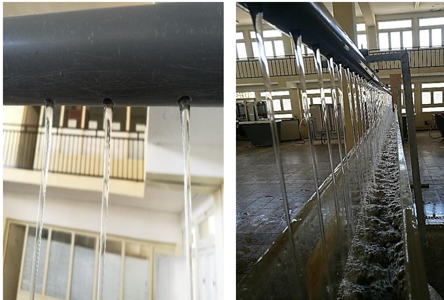
Figures (II.4) : Trous de la conduite d'apport.
