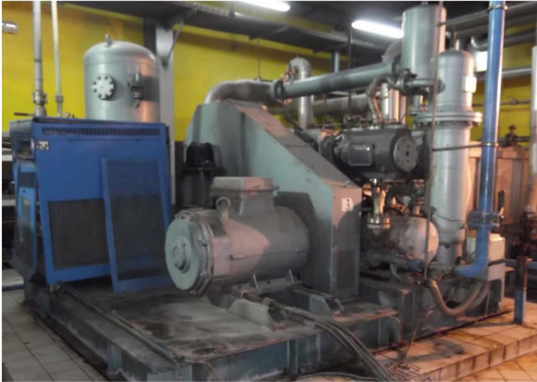
Figure II.1 : Le compresseur ATLAS COPCO CREPELLE
