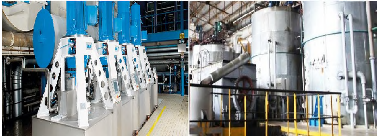
Figure I.5. Les centrifugeuses et les chaudières (cristallisation HP)
