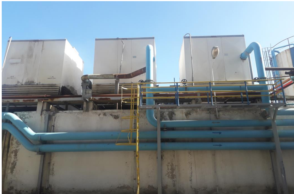
Figure I.12 : Les tours de refroidissements
