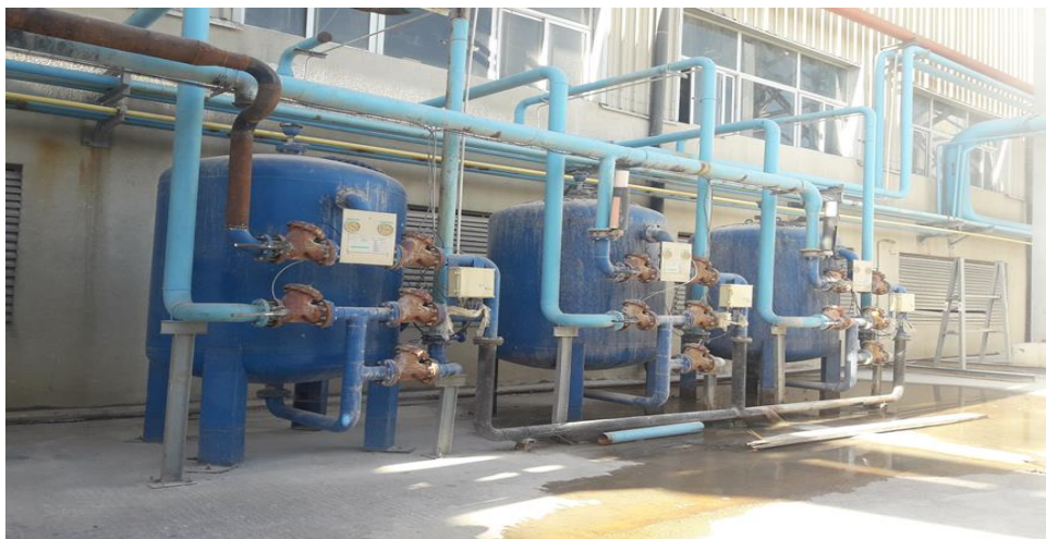
Figure I.10 : Les filtres à sable
