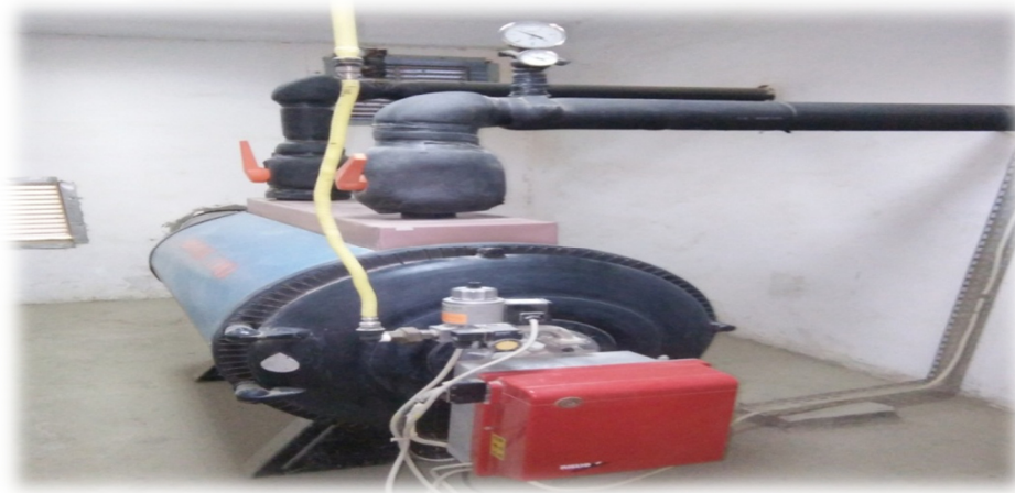
Figure I.1 : Générateur d'eau chaude.
