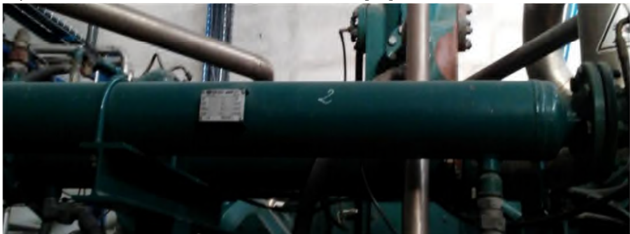
Figure II.I.13 : Échangeur vue extérieure.
