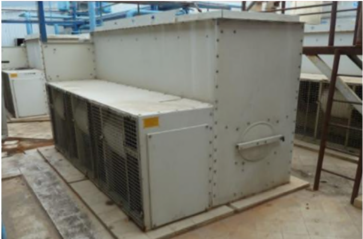
Figure II.I.12: Tour de refroidissement.
