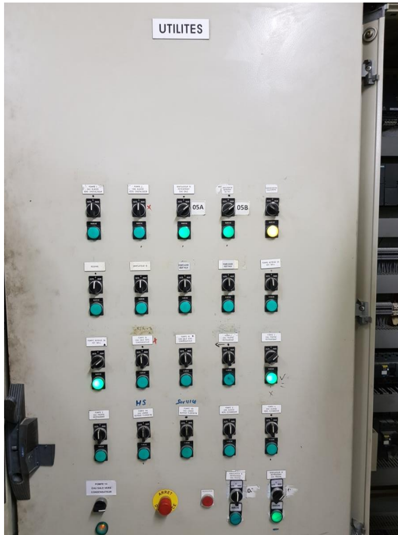
Figure I.24: Armoire de la section des utilités.
