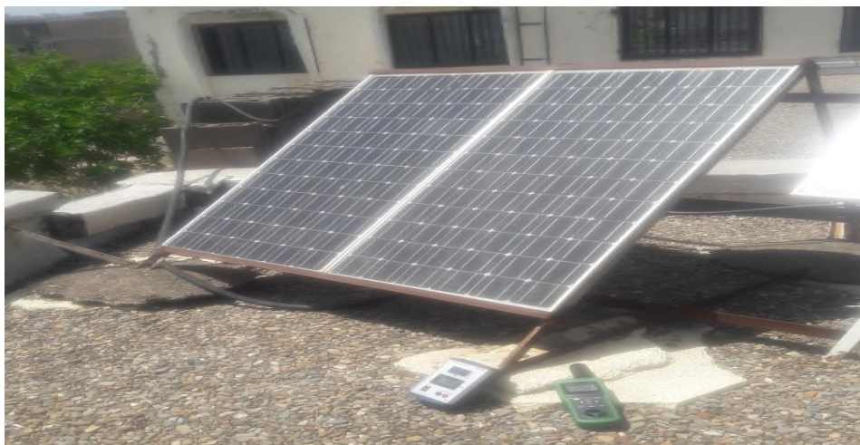
Figure III.3 : Générateur photovoltaïque avec support.
