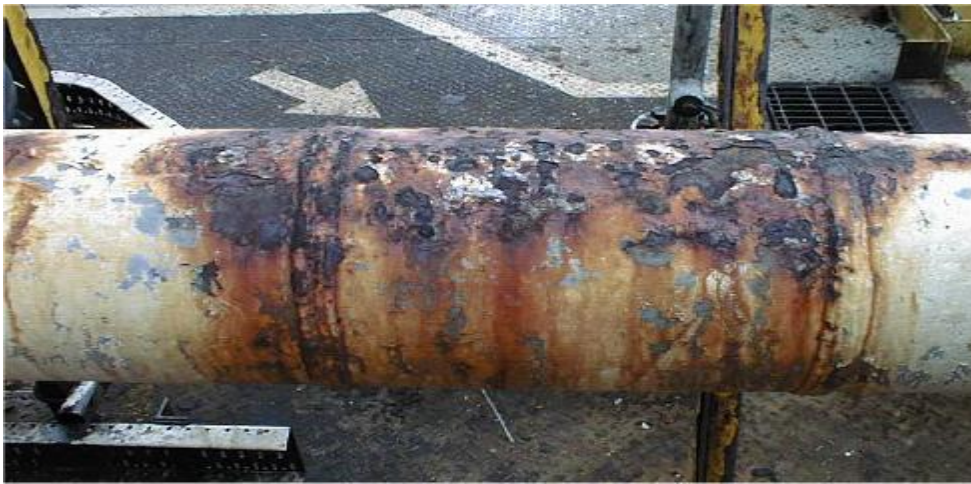
Figure.II.5. Pertes de métal dues à la corrosion externe
