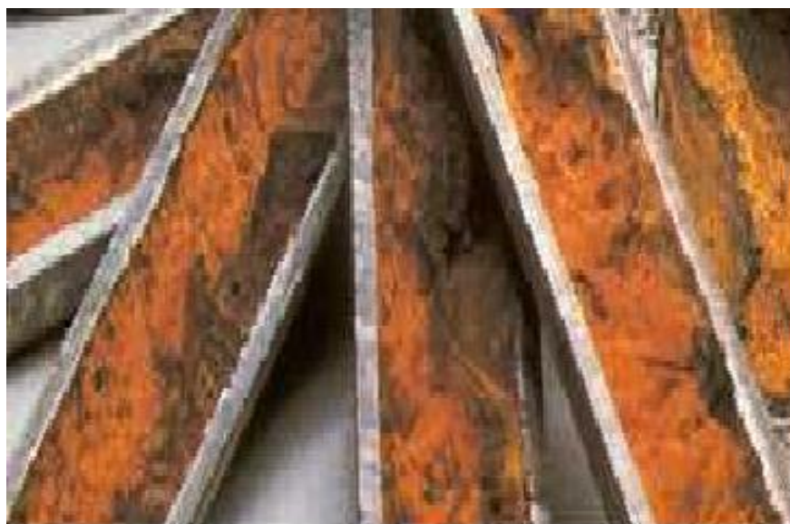
Figure.II.4. Pertes de métal dues à la corrosion interne
