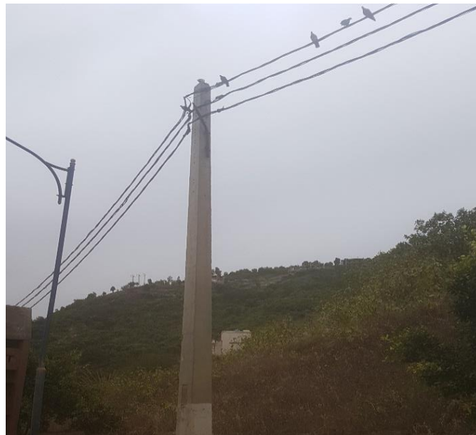
Figure 10 : Réseau électrique aérien
