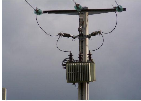
Figure 4 : poste sur poteau (ACC)
