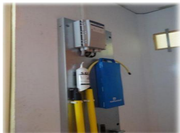
Figure 13 : matériel de sécurité dans un poste MT/BT
