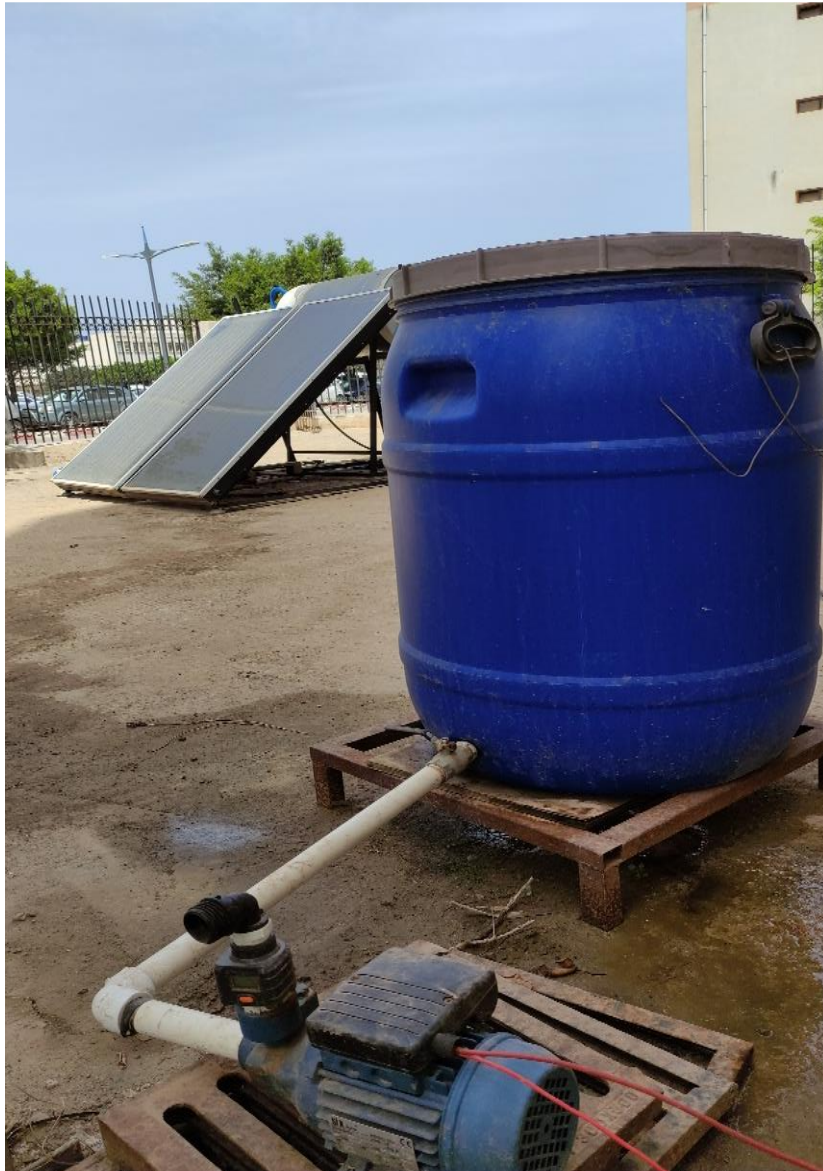
Figure IV. 2 : Photo de l'installation du système pompage-photovoltaïque sur site d'implantation.
