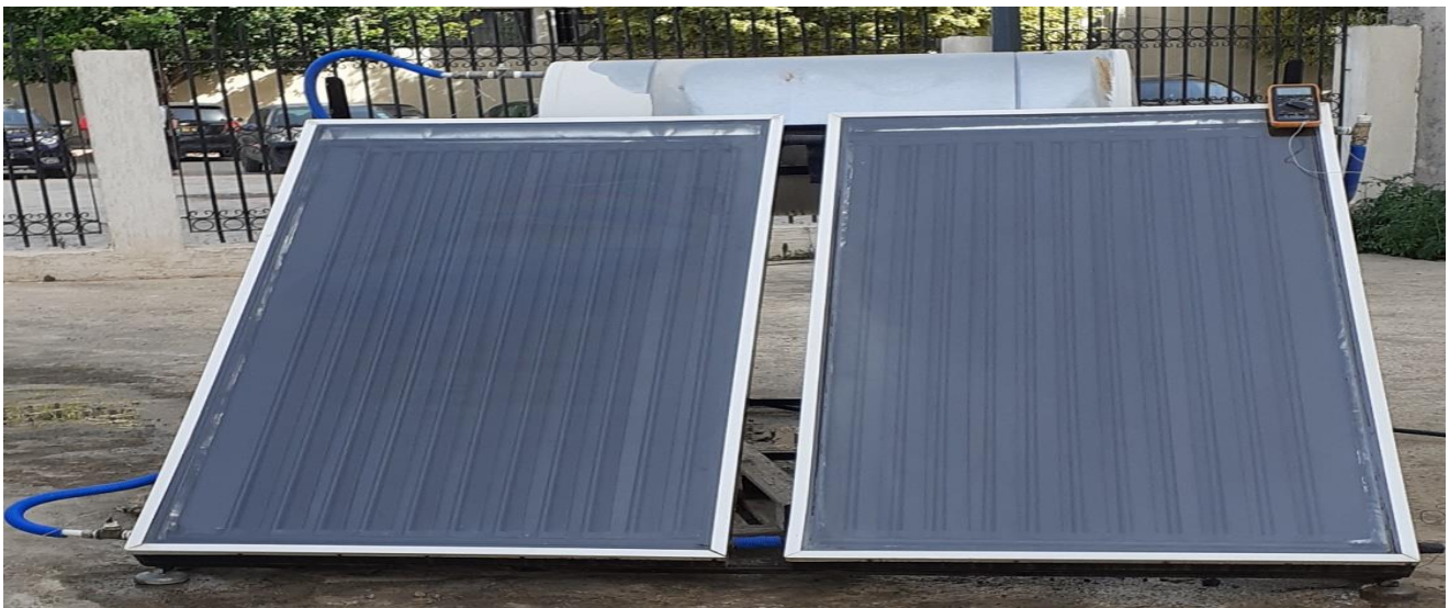
Figure III. 4 : Le chauffe-eau solaire étudié.
