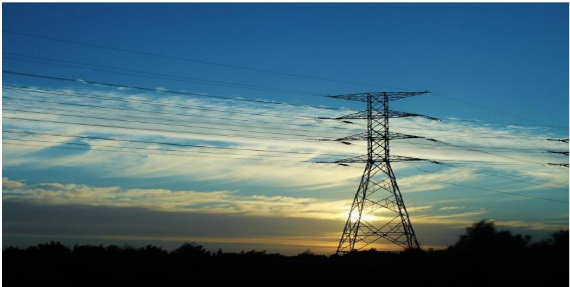
Figure II.6. Image de ligne de transport de réseau électrique
