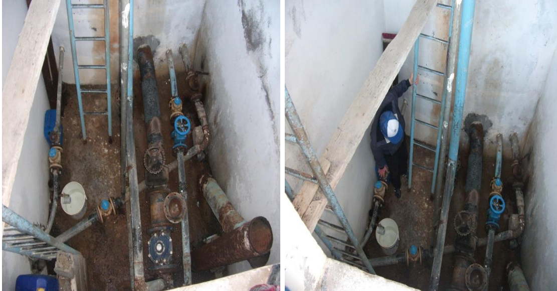
Figure II.1 : Etat actuel délabrant de la chambre de vanne et équipement hydromécanique.
