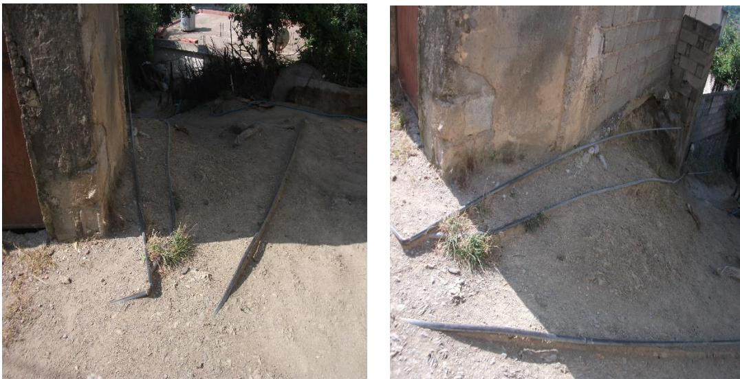
Figure II.6 : Plusieurs branchement particuliers au même endroit et avec des diamètres importants.
