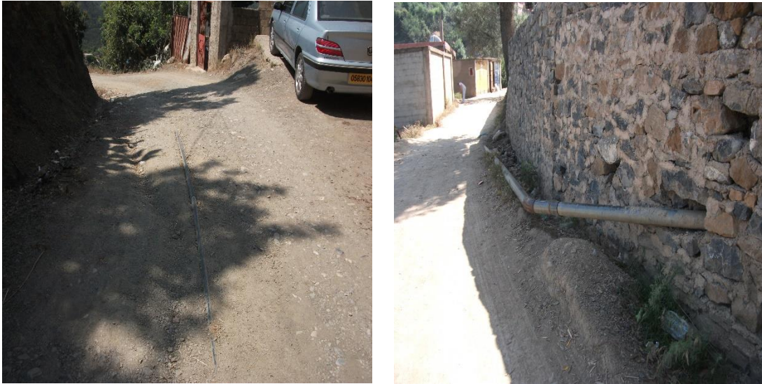
Figure II.5 : Conduites apparentes dans des accotements, dans des murs et au milieu des routes carrossables.
