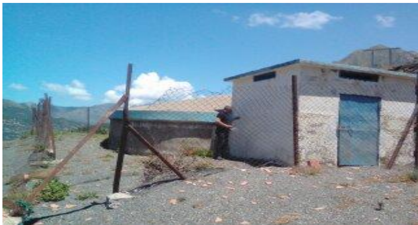
Figure II.2 : Vue extérieure du réservoir Ait Attik avec clôture en mauvais état.
