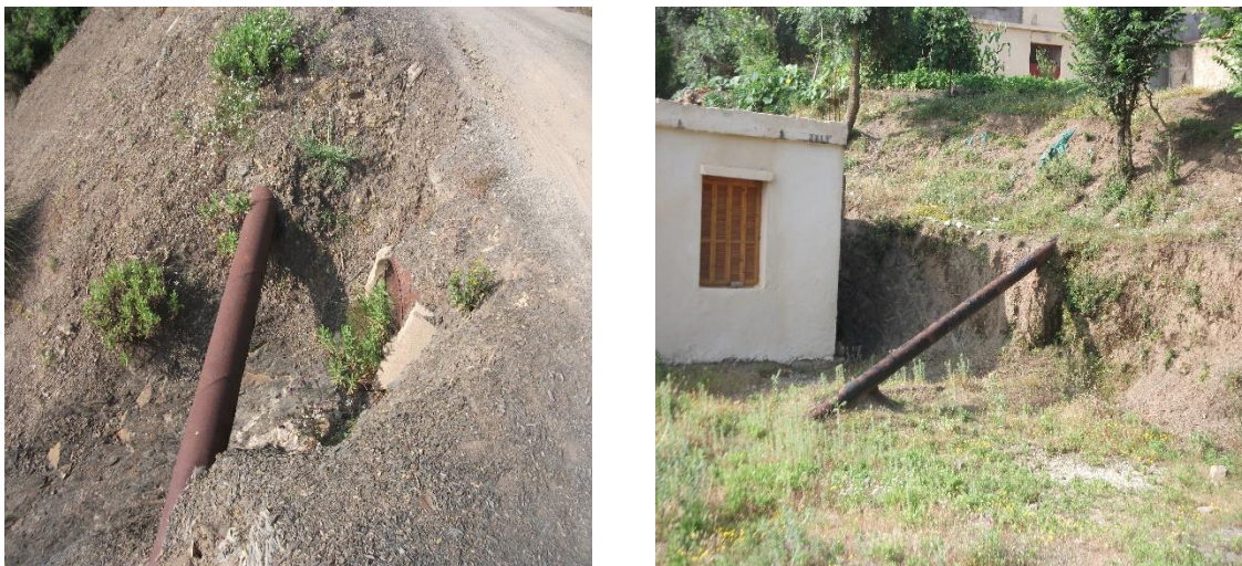
Figure II.4: Conduites en acier dans un état enrobé et sans protection, sans entretien dans plusieurs endroits et soumises aux accidents de surfaces.
