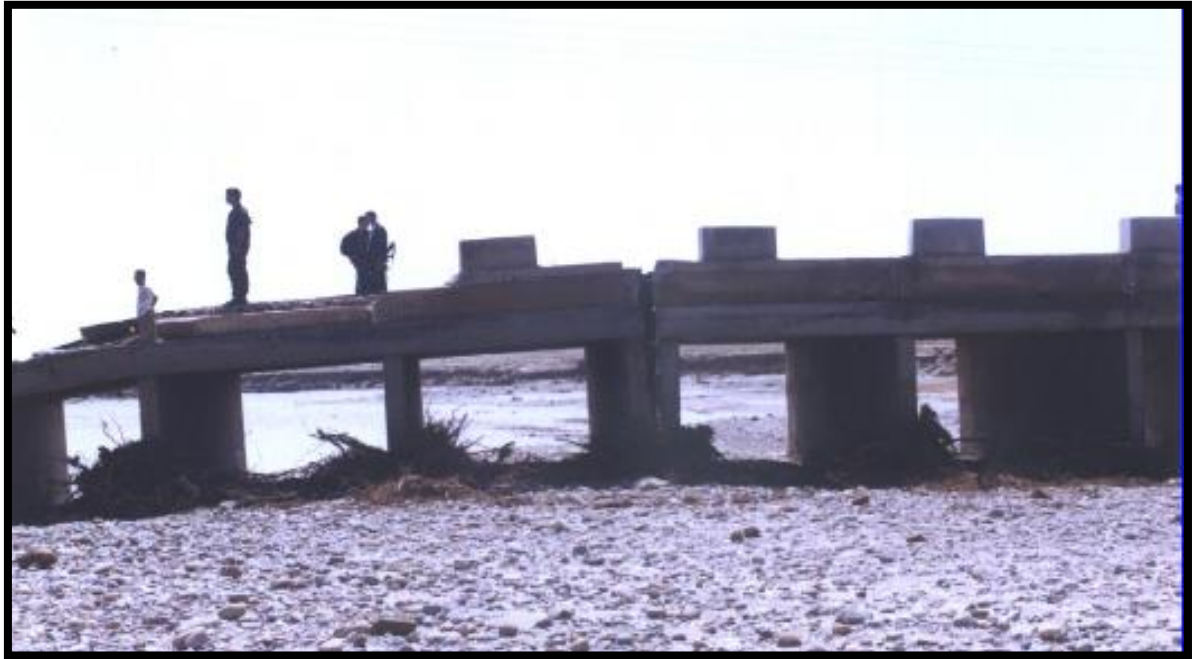
Fig I.12 : Destruction du pont d'Oued Barika (Batna)
