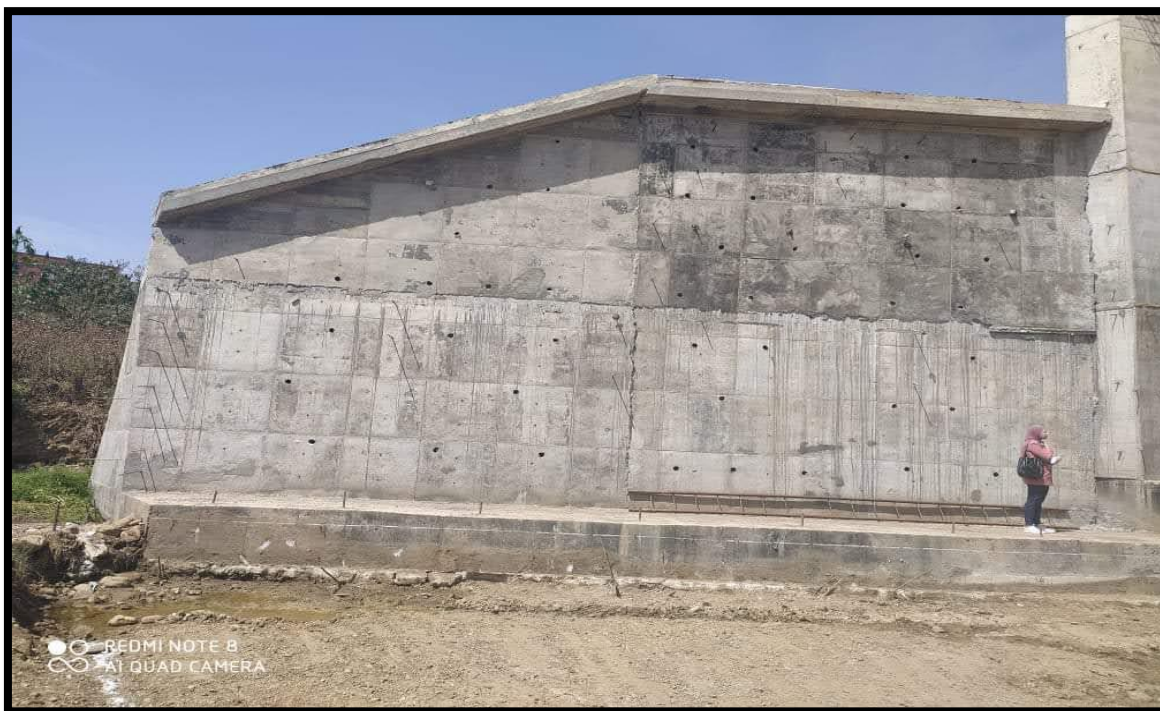
Fig III.4 : Mur en aile (El Kseur, 2021)
