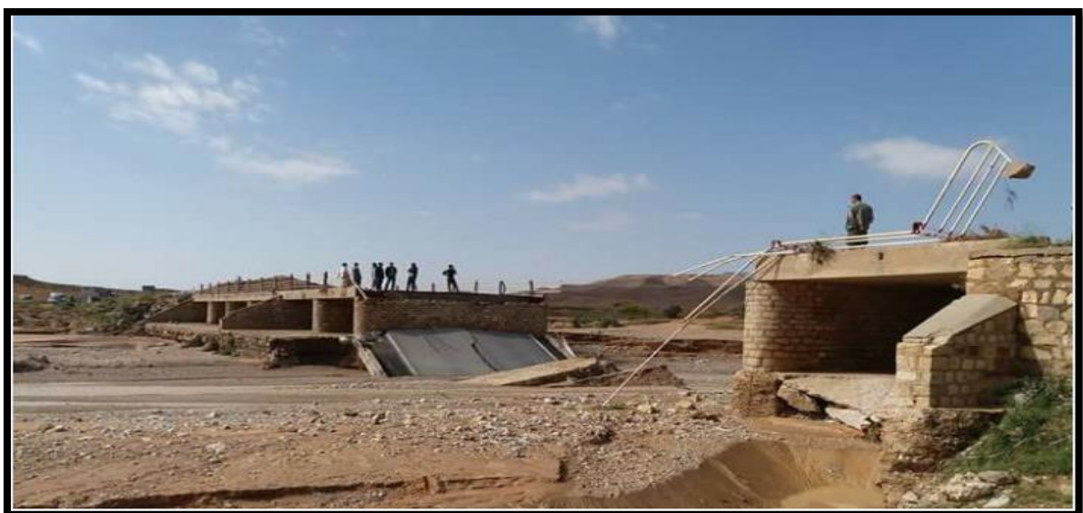
Fig I.14 : Effondrement du pont d'oued Bourdim (Msila)
