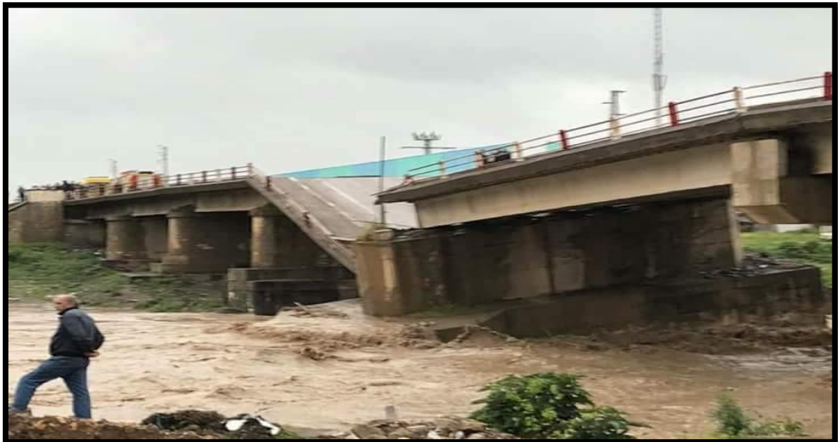
Fig I.11 : Destruction du pont d'Oued Alleug (Blida)
