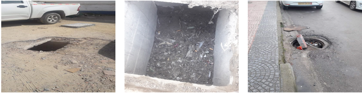
Figure III-12 : Quelques regards sans tampon dans la ville de Bejaia.
