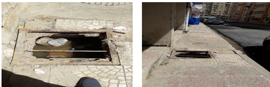
Figure III-13 : Quelques regards avec tampons cassés dans la ville de Bejaia.
