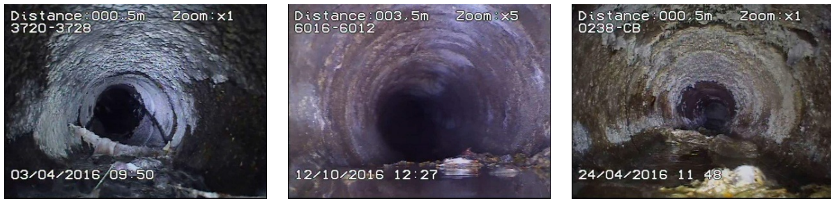
Figure III-6 : Exemples de dégradation de surface dans les conduites du RAU de la ville de Bejaia (ONA, 2018).
