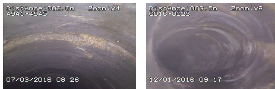
Figure III-4 : Exemple de fissures dans les conduites du RAU de la ville de Bejaia (ONA, 2018).
