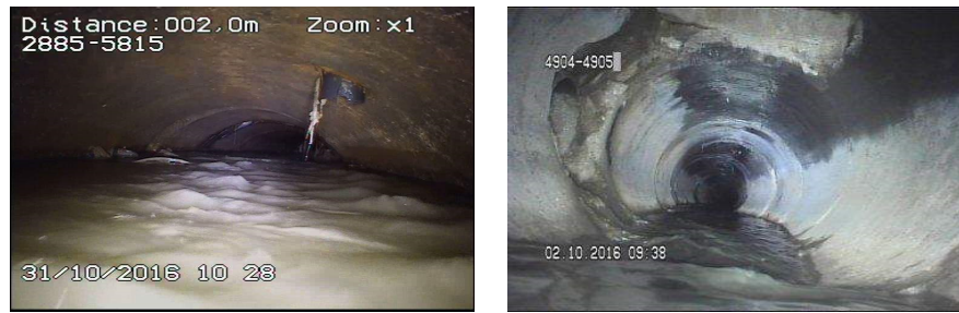
Figure III-7 : Exemples de branchements illicites dans les conduites du RAU de la ville de Bejaia (ONA, 2018).
