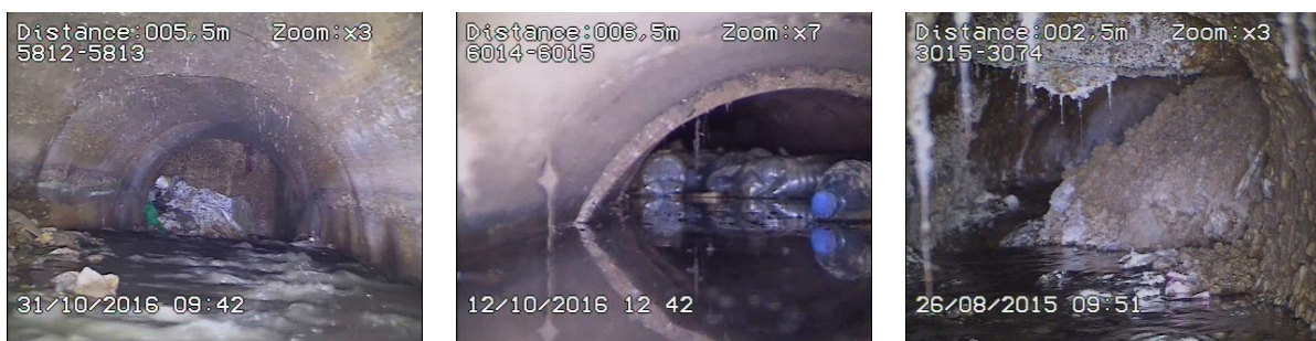
Figure III-10 : Exemples de dépôts dans les conduites du RAU de la ville de Bejaia (ONA, 2018).
