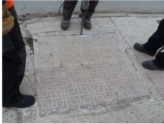
Figure IV-4 : Tentative de dégagement d'une dalle d'un regard.
