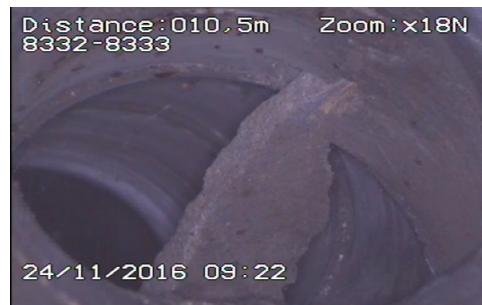
Figure III-5 : Exemple d'un effondrement dans une conduite du RAU de la ville de Bejaia (ONA, 2018).
