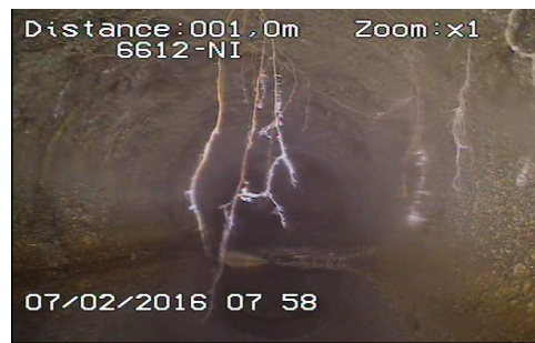
Figure III-11 : Exemple de pénétration de racines dans une Conduite du RAU de la ville de Bejaia (ONA, 2018).
