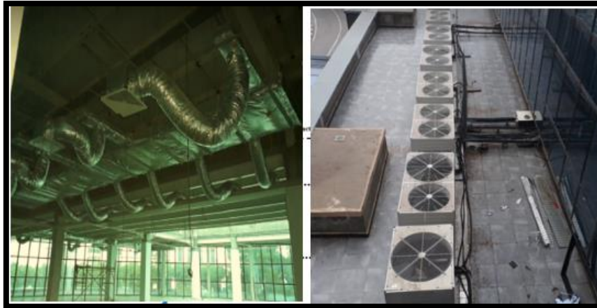
Figure 3.22 : Dispositifs de ventilation mécanique
