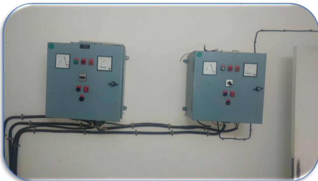
Figure III-16. Coffrets de commande.
