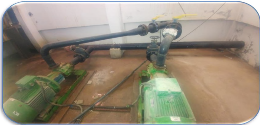
Figure III-10. Equipements Electro et Hydromécaniques en bon état.
