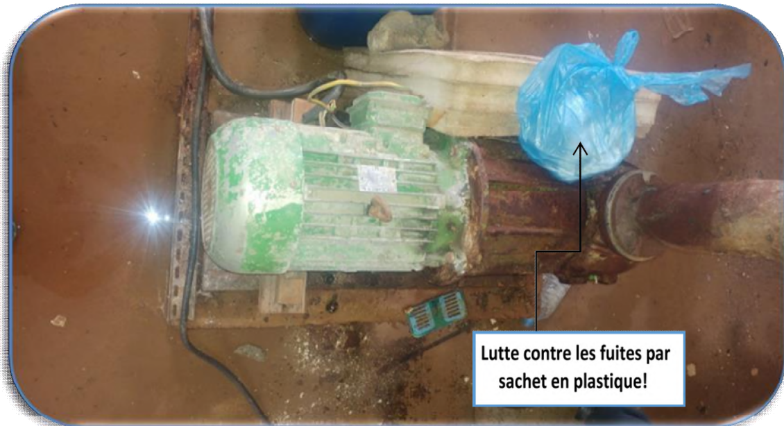
Figure III-15. Sachet en plastique pour éviter les éclaboussures dues aux fuites importantes du GEP.
