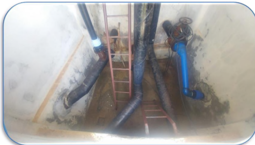
Figure III-18. Equipements hydromécaniques de la chambre de vannes.
