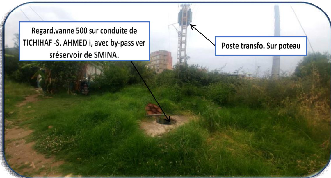
Figure III-2. Le poste transformateur sur poteau.
