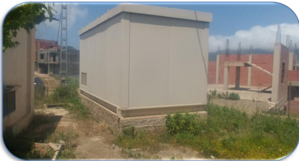
Figure III-8. Le poste transformateur.
