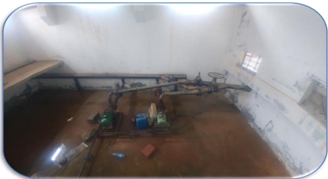
Figure III-14. Vue d'ensemble de la salle des pompes.
