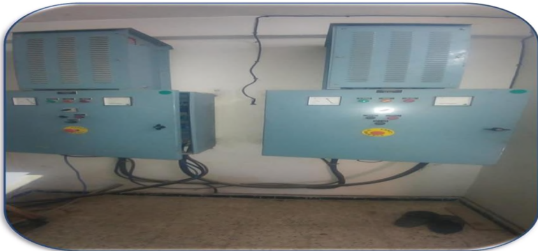
Figure III-11. Coffrets de commande en bon état.
