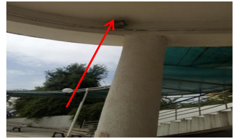
Figure.2. 12: les projecteurs Source : Auteurs, 2021
