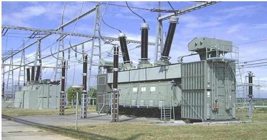
Figure I-4 Transformateur de puissance d'un poste électrique[6]
