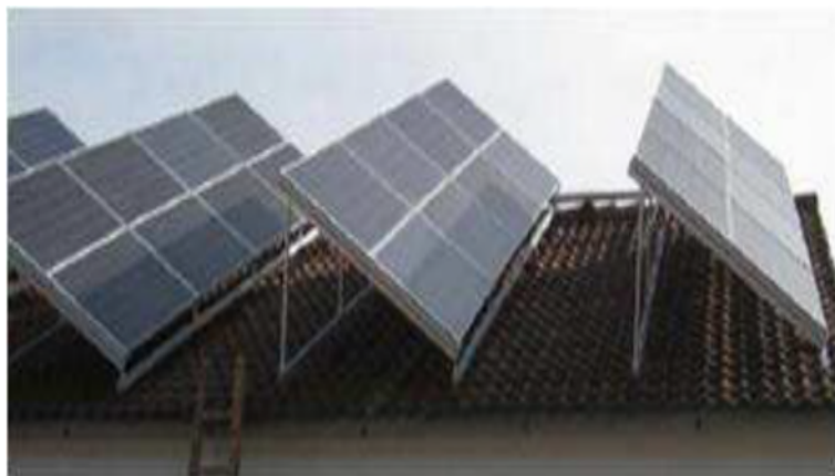
G) mauvaise installation
