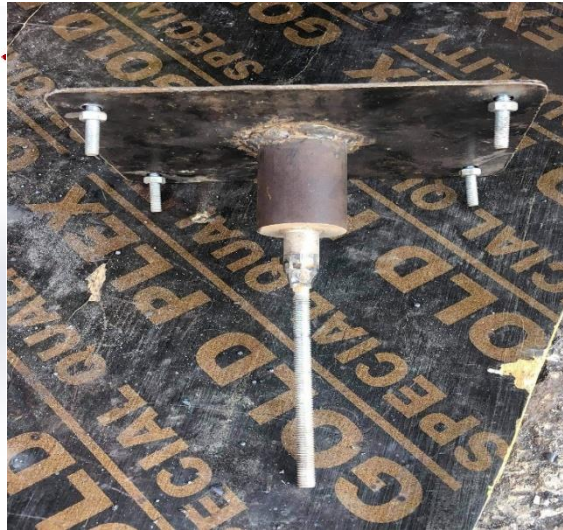
Figure III.19 : Photo réelle du support de la nacelle.
