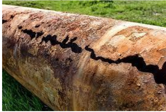
Figure II.1 - Perte de métal dû à une corrosion profonde (interne/externe)
