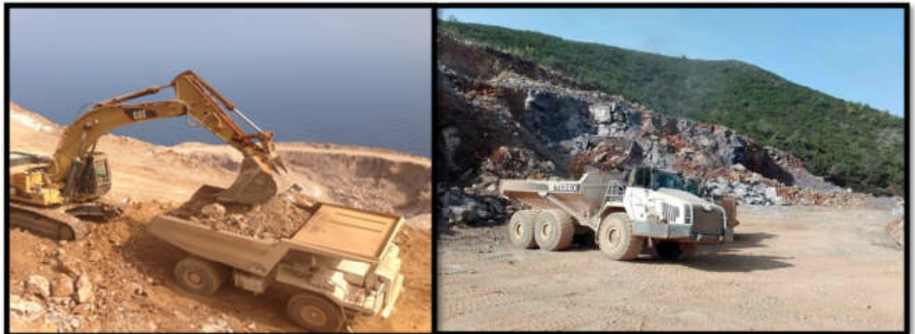
Figure III.5 : Camion terex (prise à Adrar Oufarnou).
