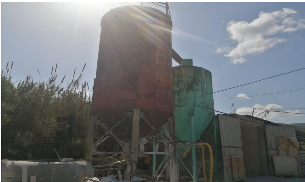
Figure 24 : cuves de stockage et de traitement des eaux (prise le 04/04/2021)
