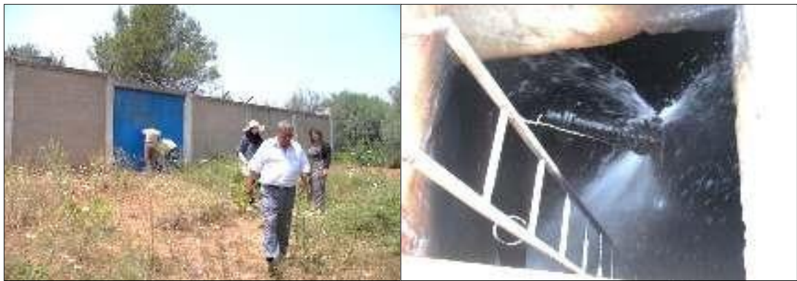
Figure II-17 : Vue d'extérieur du réservoir R 1 Figure II-18: Fuite au niveau du flotteur
