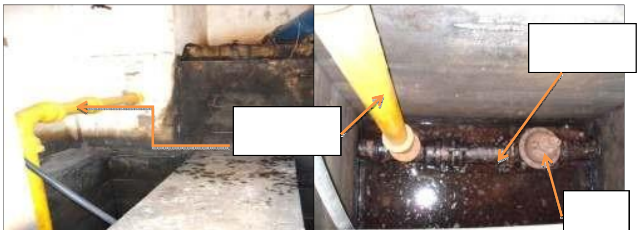
Figure II-25: conduites de trop plein et de vidange
