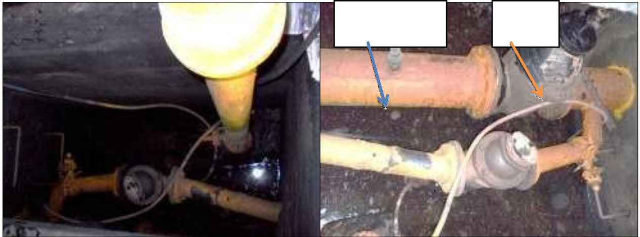
Figure II-23 : dégradation des conduites, fuites dans un mauvais état et les câbles électriques sont mal placés.
