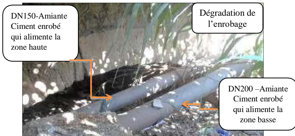
FigureII-26 : Passage des deux conduites de distribution en parallèle sous le pont à l'entrée de la ville.
