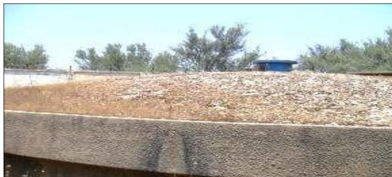
FigureII-22 : Erosion de la coupole réservoir 200m 3 enterré
