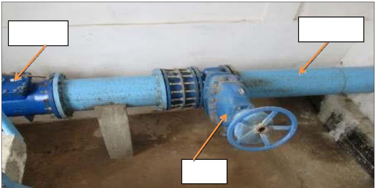
FigureII-13 : Conduite de distribution
