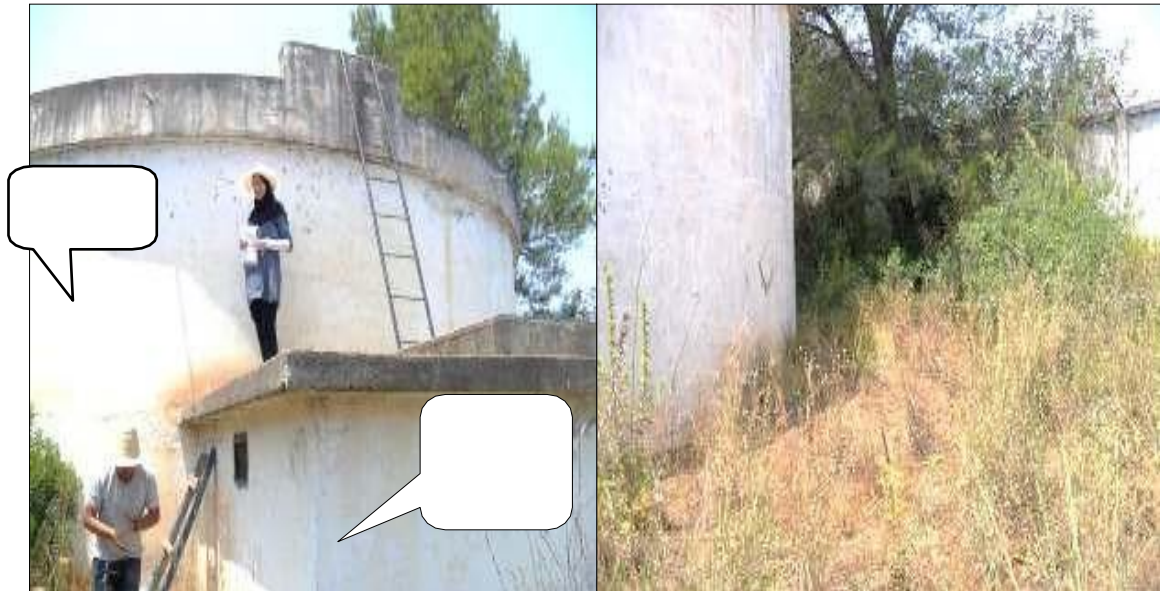
Figure II-19 : Réservoir 300m 3 semi enterré
