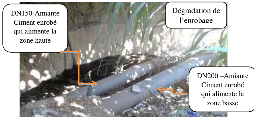
FigureII-28 : Passage des deux conduites principales de distribution en parallèle sous le pont à l'entrée de la ville.
