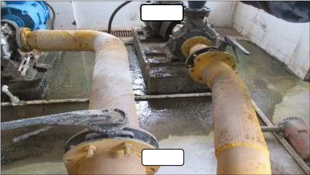
FigureII-08 : Détérioration de la station.
