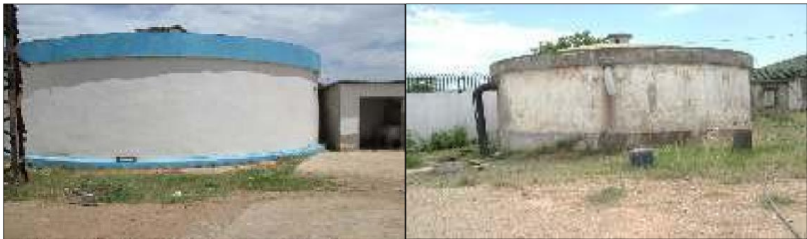
FigureII-14 : Vue du réservoir 300m 3 FigureII-15 : Dégradation de l'état du réservoir
