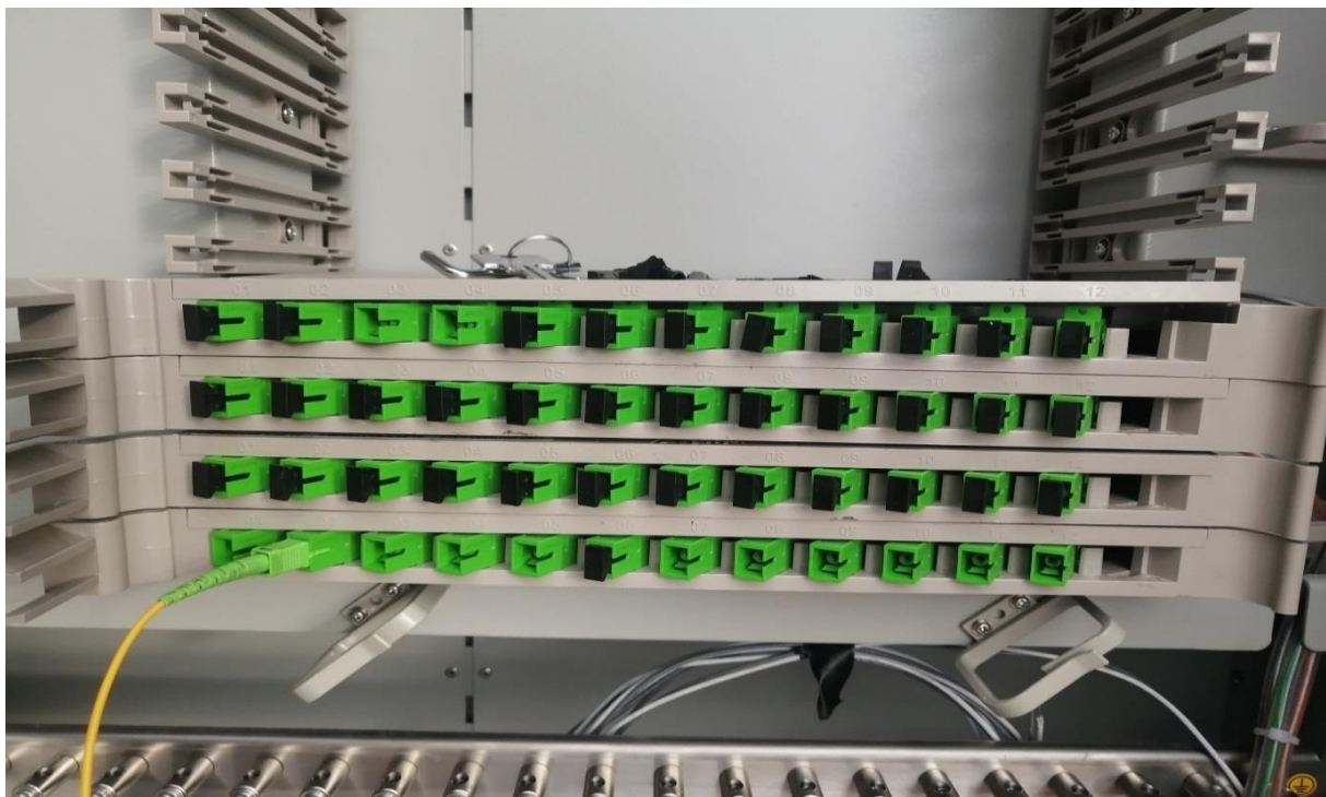
Figure II.19: Les cassettes de FDT.
