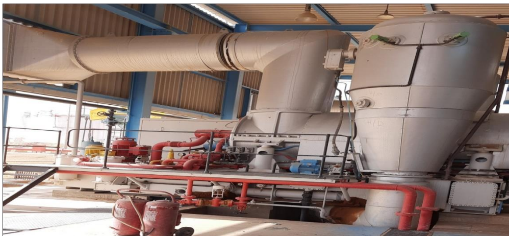
Figure I.12 : Les pompes (photo prise en entreprise).
