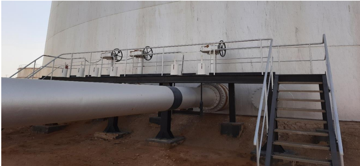
Figure I.8 : Les vannes manuelles (photo prise en entreprise).
