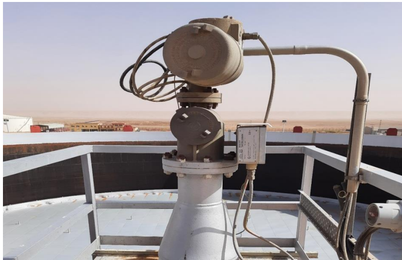
Figure I.10 : Le transmetteur de niveau (photo prise en entreprise).
