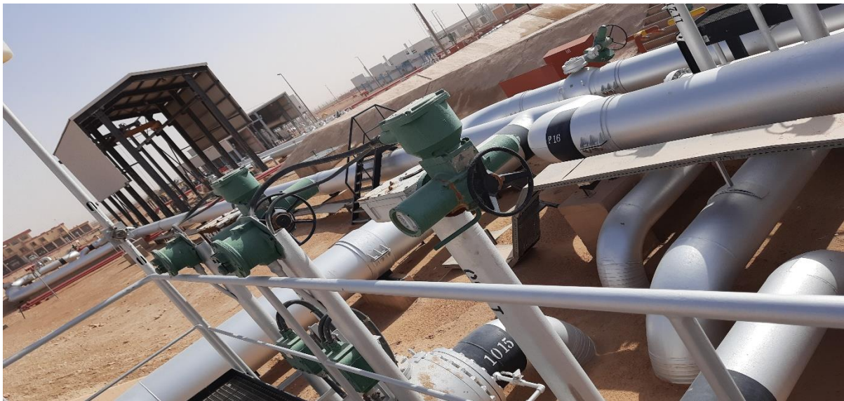
Figure I.9 : Les vannes commandées (photo prise en entreprise).
