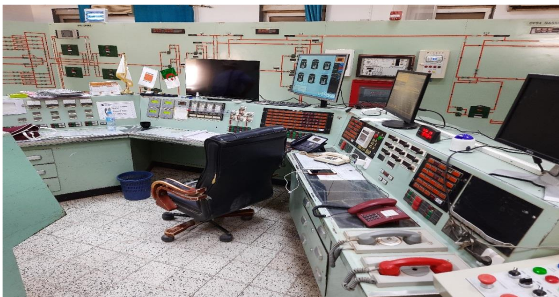
Figure I.16 : Ancien salle de contrôle (photo prise en entreprise).
