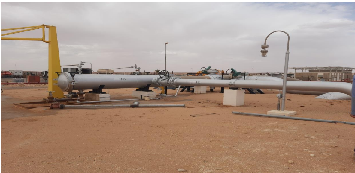
Figure I.5 : Gare de racleur arrivée du brut (photo prise en entreprise).
