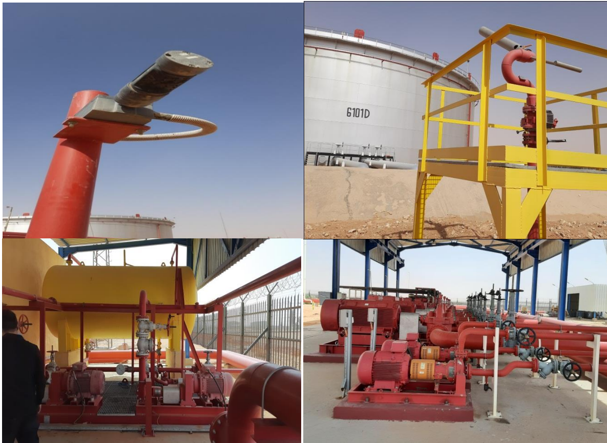
Figure I.14 : Système de sécurité (photo prise en entreprise).
