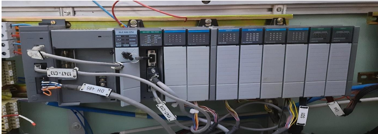
Figure II.2 : L'automate programmable Allen Bradley SLC 500 «photo prise en entreprise».
